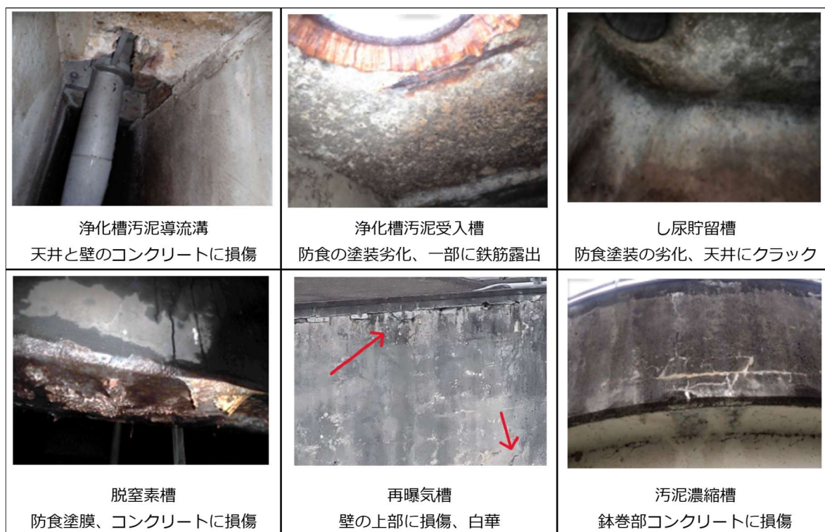
図1.3.2 計画的に補修が必要なRC水槽
