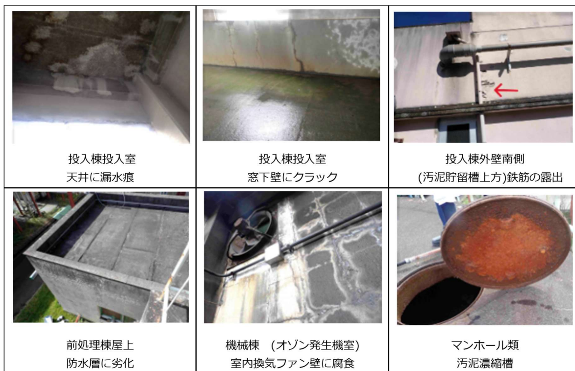
図1.3.4 計画的に補修が必要な建築設備
