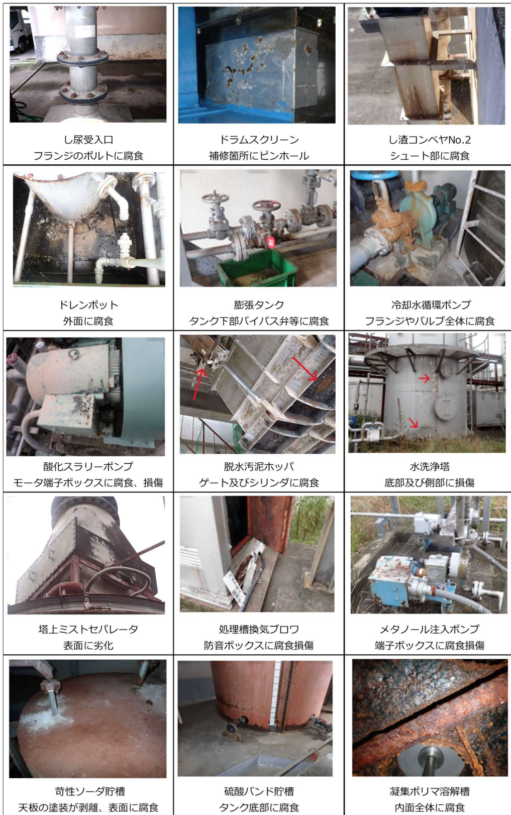
図1.3.3 計画的に補修が必要な機械設備
